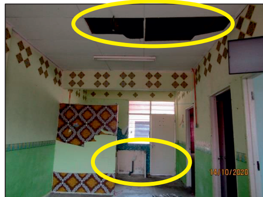
Rumah Bernombor C-144 - Kerosakan Siling dan Kehilangan Singki (14.10.2020) (Sumber: Jabatan Audit Negara)
